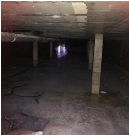
Imagen 1: Agua en los sótanos. N1
